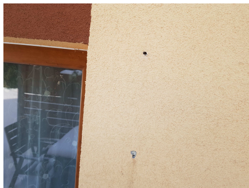
Poškození omítky do zahrady
