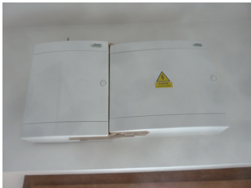
Bytový rozvaděč nad vstupními dveřmi
