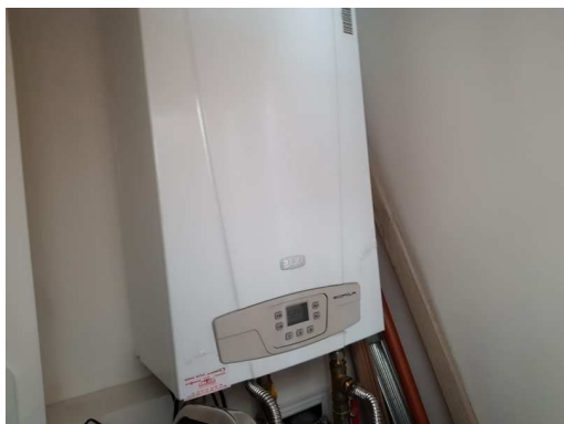
Plynový kotel (místnost B.04)
