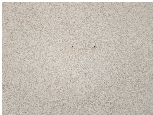
Poškození omítky – kotvení hřebíčky
