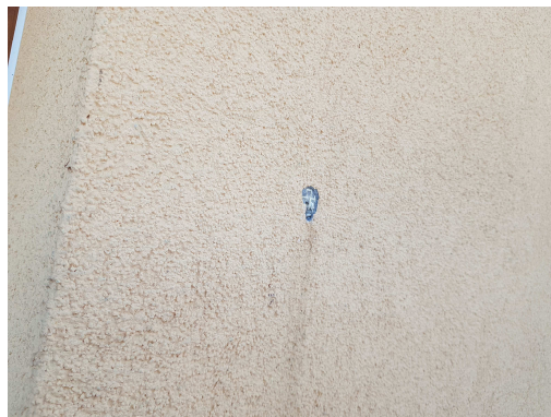
Poškození omítky do zahrady
